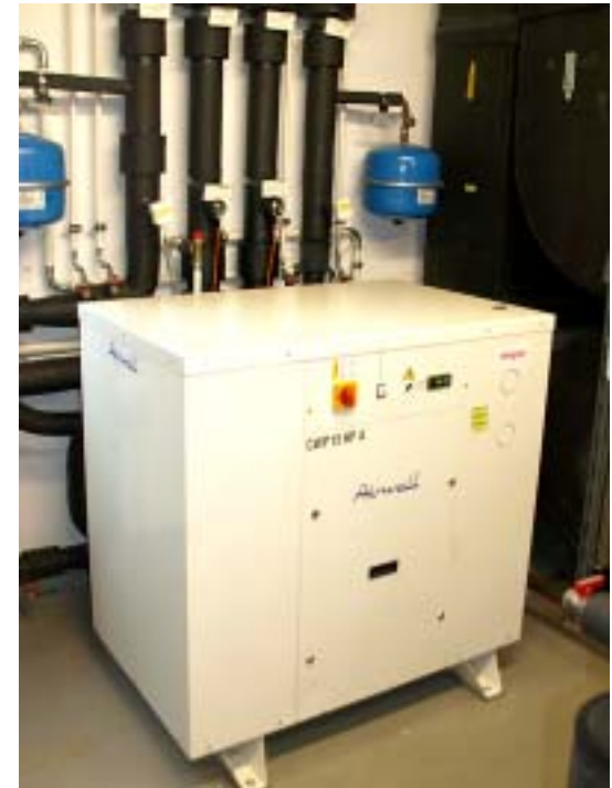
Das Herzstück Wärmepumpe
